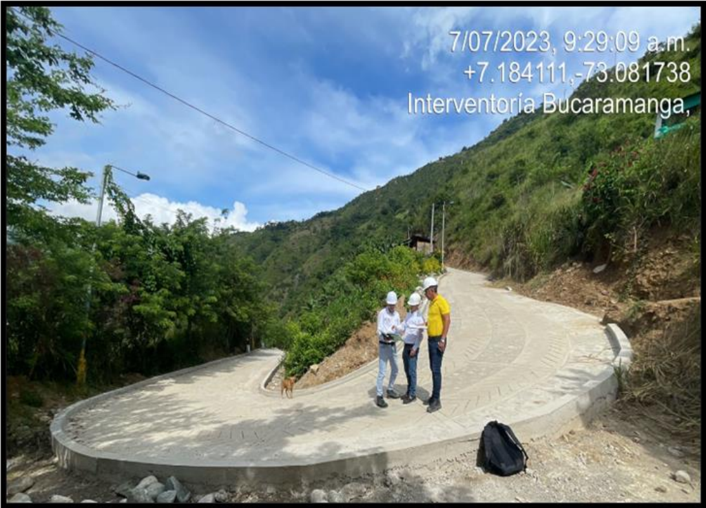
TRAMO VEREDA CAPILLA BAJA – ESCUELA II
